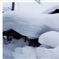
屋根が壊れそう!
